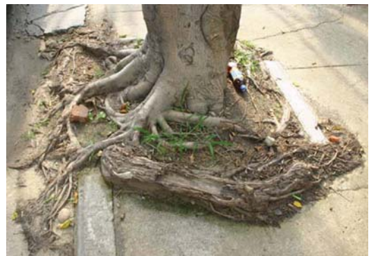
圖 18. 地表根盤踞於水泥鋪面
