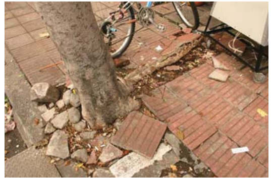
圖 10. 鋪面下方之垂榕粗壯根群造成植穴周邊地磚毀損
