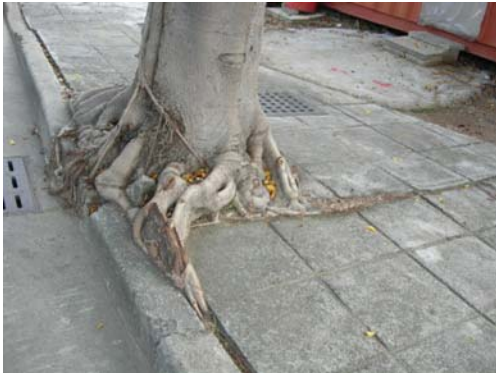
圖 15. 地表根鑽入水泥鋪面與路緣石間縫隙
